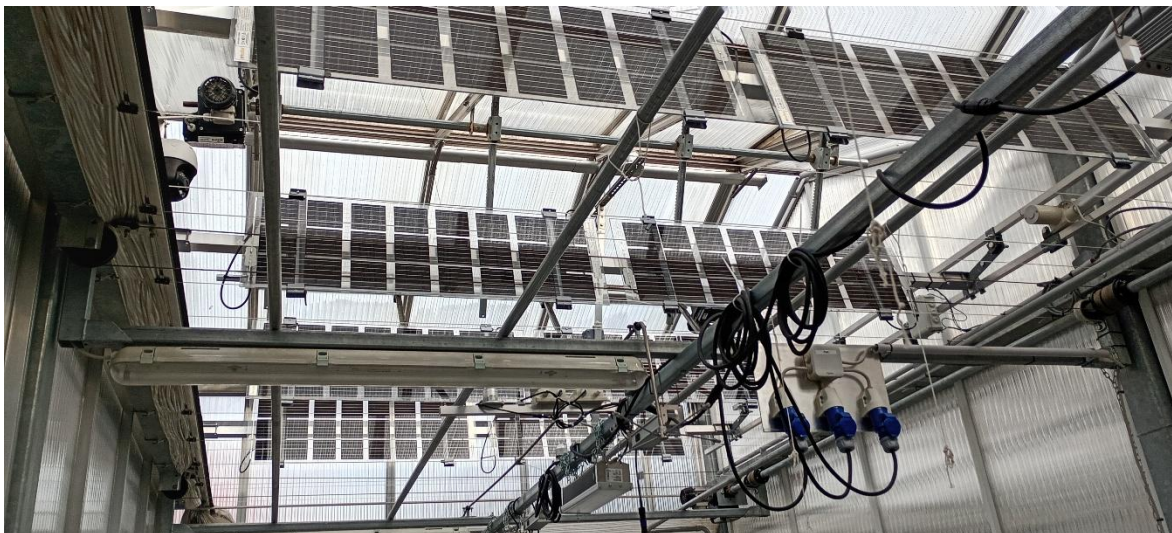
Fot. 4. Panele solarne stosowane w szklarni stosowane jako cieniówka.
