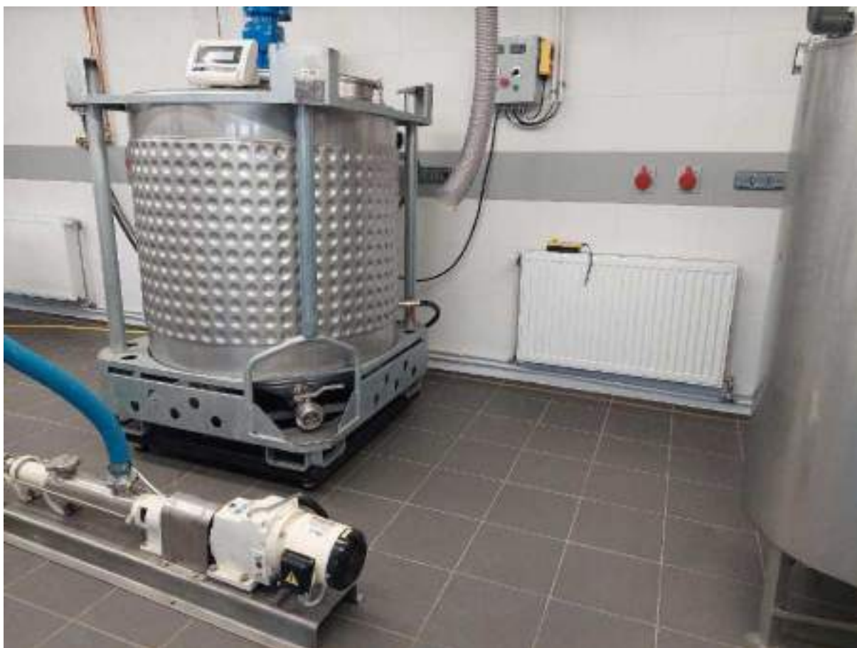
Fot. 9. Zbiornik 1000 litrowy z homogenizatorem i płaszczem wodnym (fot. M. Czelej)
