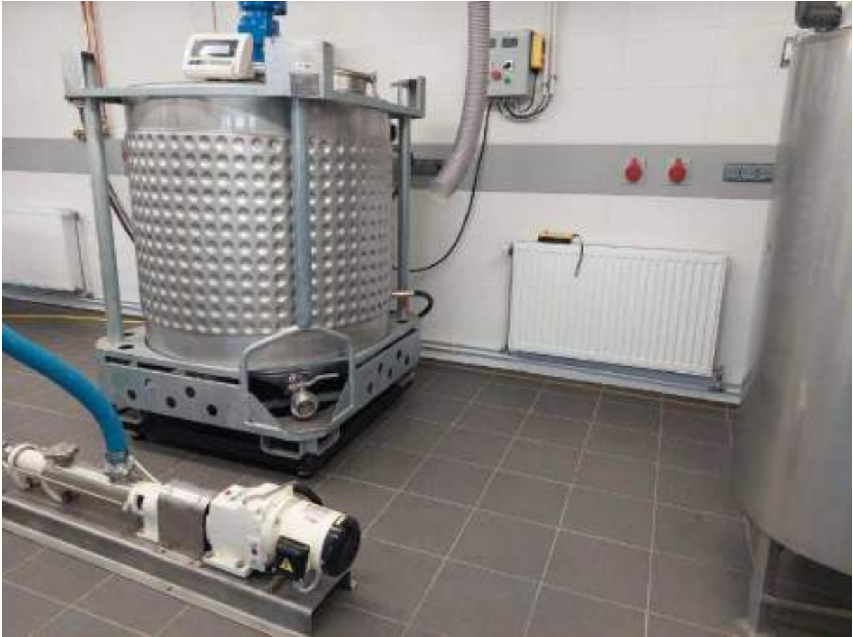
Fot. 2. Zbiornik 1000 litrów z płaszczem wodnym i homogenizatorem (fot. M. Czelej)
