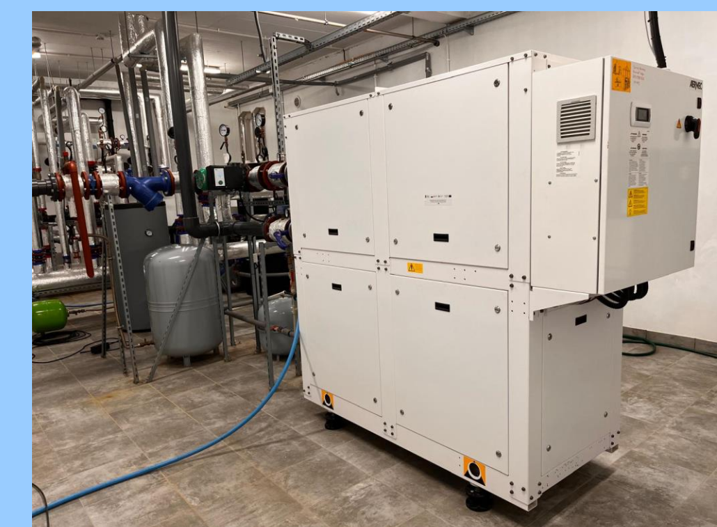
Fot. 5 Pompa ciepła
