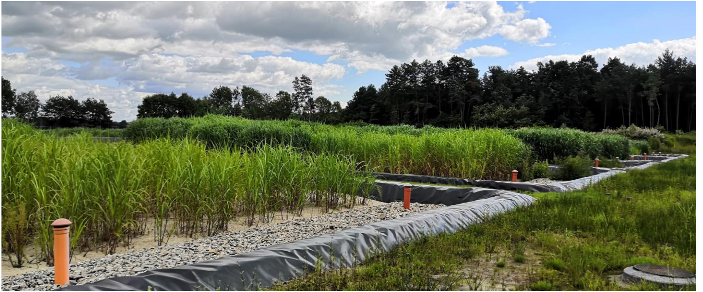
Największa w Polsce hybrydowa hydrofitowa oczyszczalnia ścieków w Białce nad jez. Białskim (gmina Dębowa Kłoda) o przepustowości 180 m 3 /d
