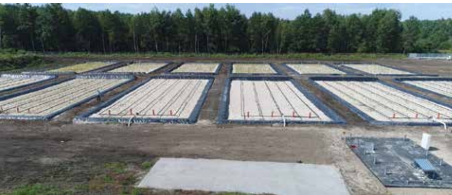
Hybrydowa hydrofitowa oczyszczalnia ścieków w Białce – gmina Dębowa Kłoda Fot. Radomir Obroślak
