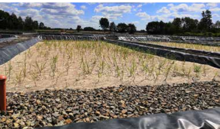
Hybrydowa hydrofitowa oczyszczalnia ścieków w Białce – gmina Dębowa Kłoda we wrześniu 2020 r. Fot. Krzysztof Józwiakowski
