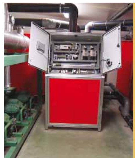
■ Podzespół instalacji chłdniczej w zakładzie produkcyjnym. Fot. Piotr Nakonieczny
